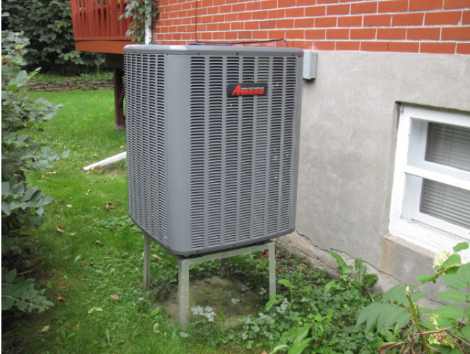
Figure 30- Condenseur et compresseur de la thermopompe
