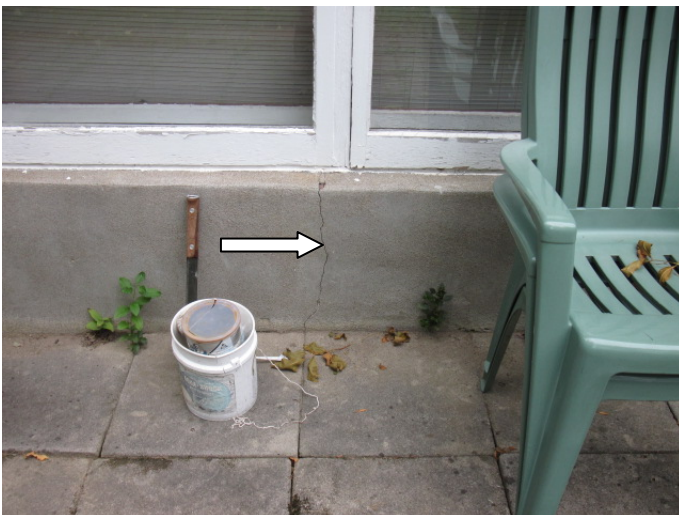
Figure 2- Fissure au mur arrière
