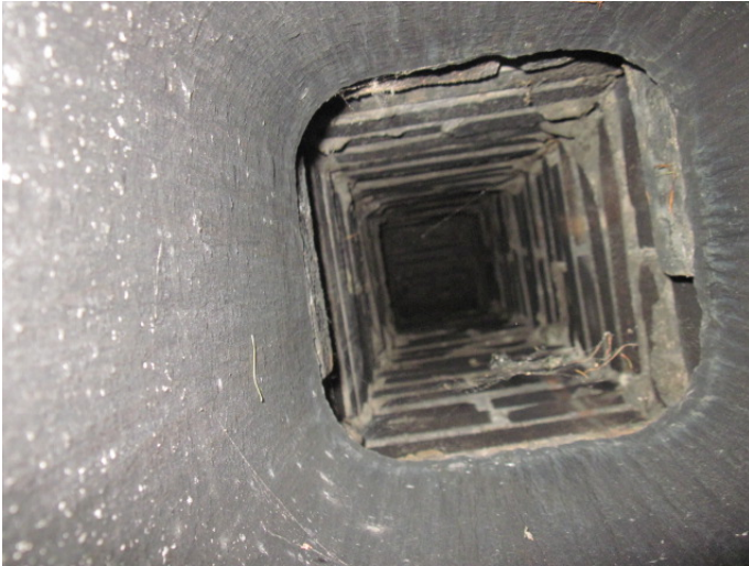
Figure 32- Absence de chemisage à l'intérieur de la cheminée
