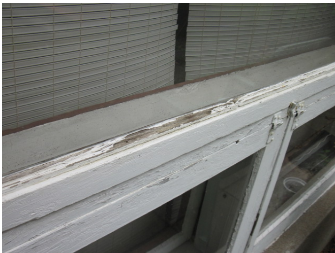
Figure 20- Bois exposé aux intempéries à la fenêtre arrière
