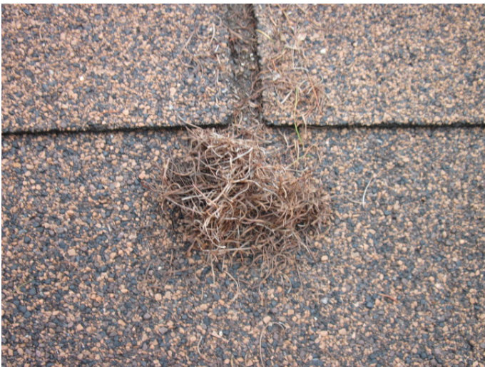
Figure 12- Matière organique entre les joints de bardeaux
