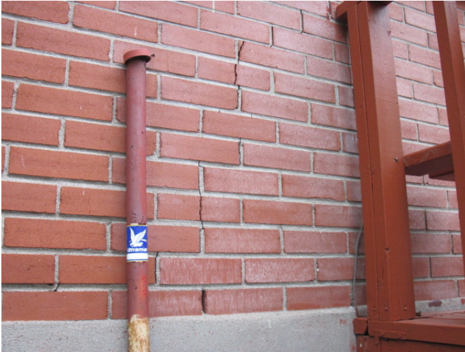
Figure 13- Briques et joints de mortier à réparer mur arrière
