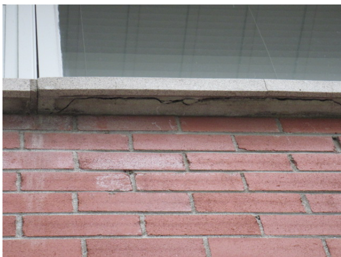
Figure 22- Allège de fenêtre arrière fissurée
