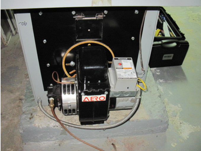
Figure 28- Fournise au mazout à air forcé
