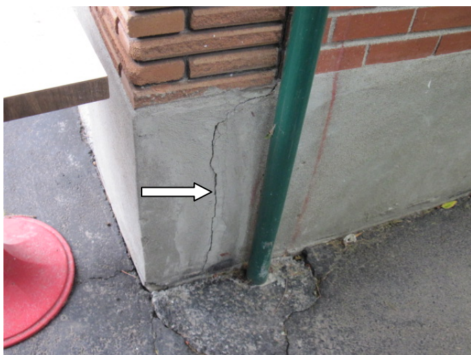
Figure 4- Fissure au mur droit avant
