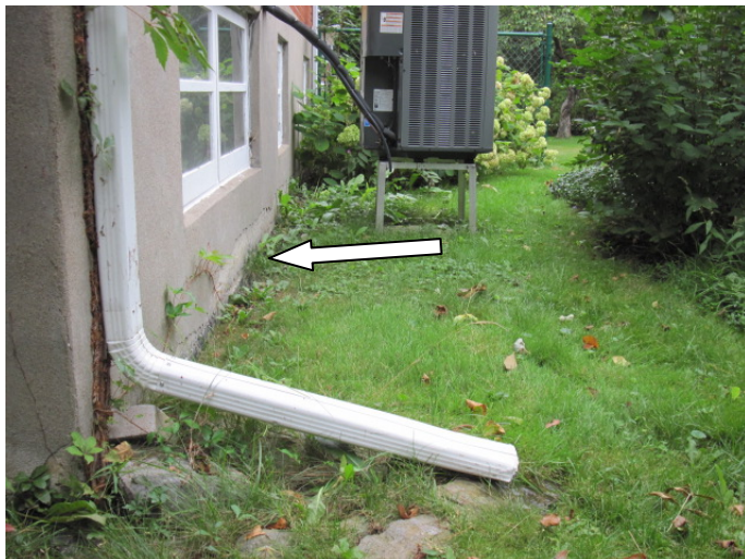
Figure 15- Mauvaise pente de terrain côté gauche
