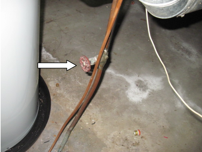
Figure 33- Valve de contrôle principale pour l'entrée d'eau
