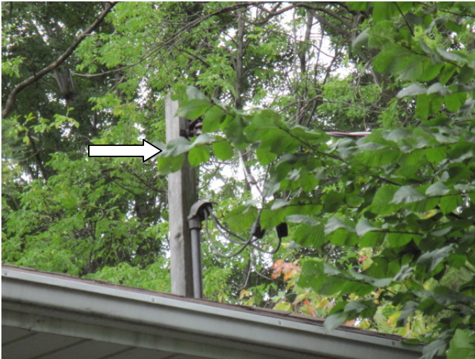
Figure 24- Mat en bois d'entrée électrique sur le toit
