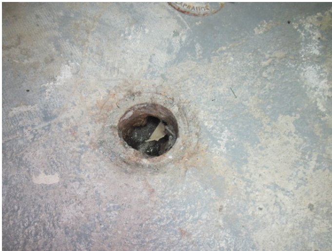
Figure 36- Clapet anti-refoulement endommagé
