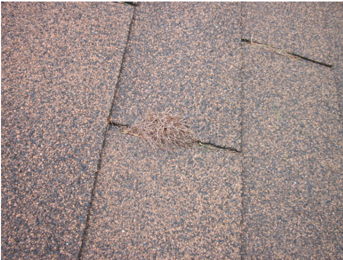
Figure 11- Matière organique entre les joints de bardeaux
