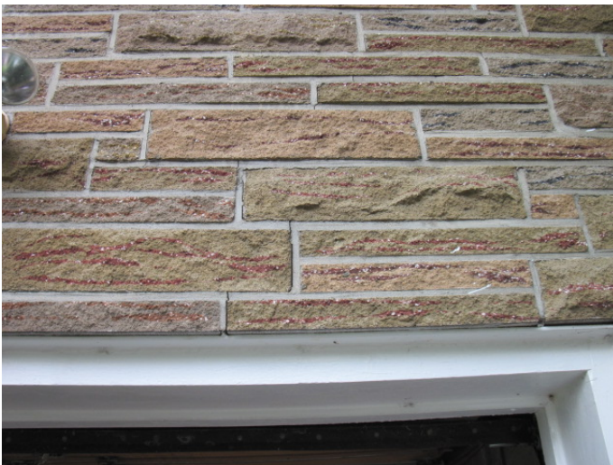
Figure 14- Joints de mortier à réparer au mur avant
