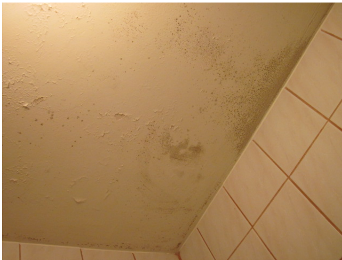
Figure 50- Apparence de moisissure au plafond de la salle de bain
