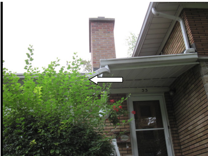
Figure 18- Décharge de gouttière avant trop près de la fondation
