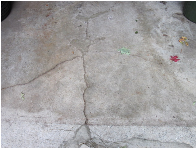
Figure 40- Fissures de la dalle de béton au garage
