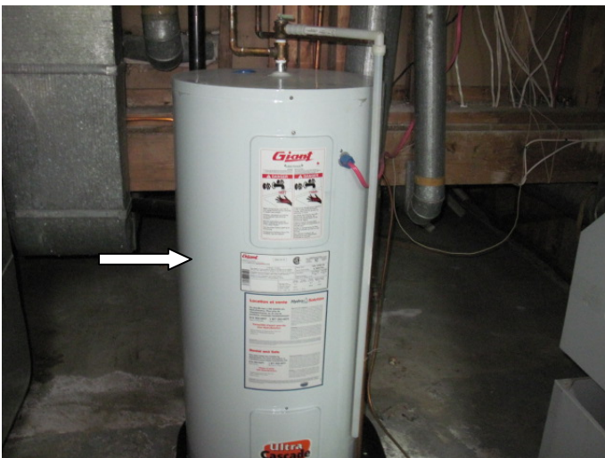
Figure 38- Chauffe-eau électrique au sous-sol
