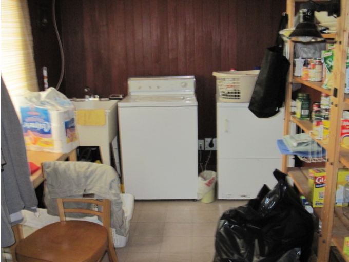
Figure 39- Installations pour laveuse et sécheuse
