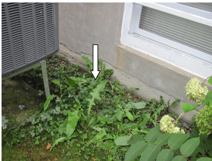
Figure 16- Tassement du sol visible sur le côté gauche
