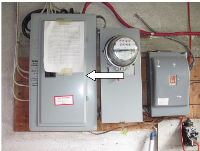
Figure 26- Panneau de dérivation ITE à disjoncteurs
