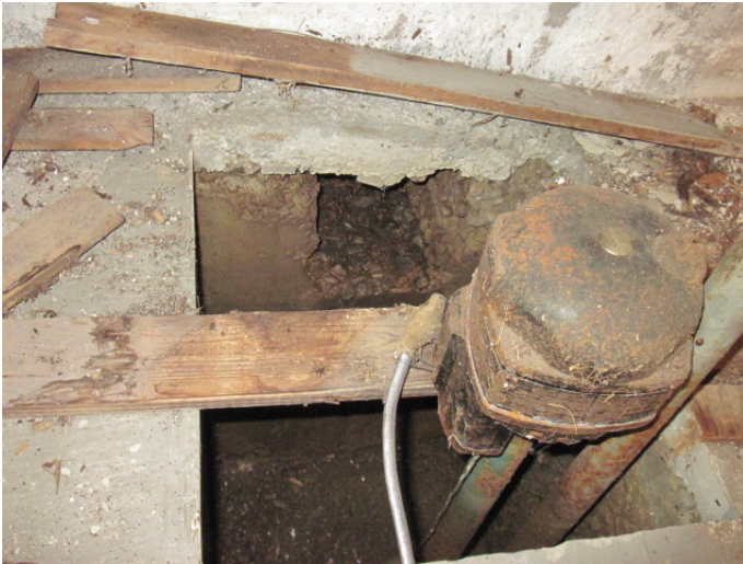
Figure 37- Bassin de captation et pompe de puisard
