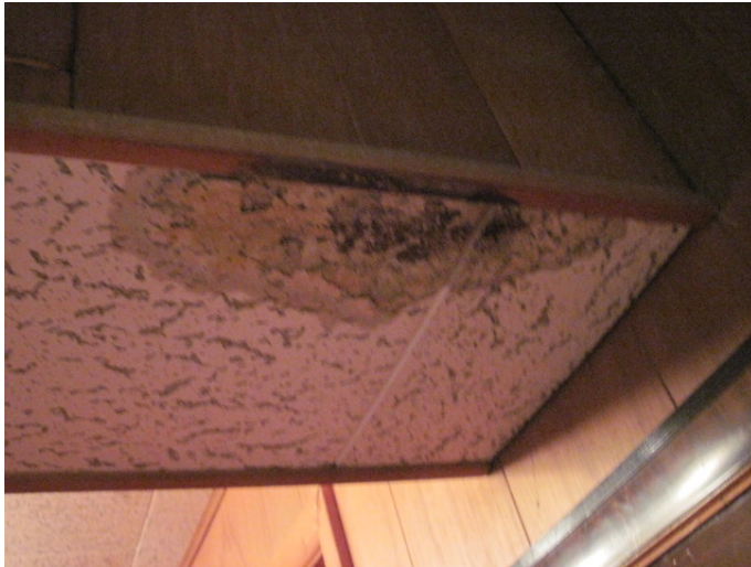
Figure 42- Cerne d'eau visible au plafond du sous-sol
