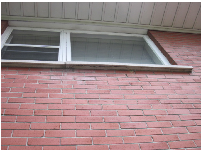
Figure 21- Allège de fenêtre arrière fissurée
