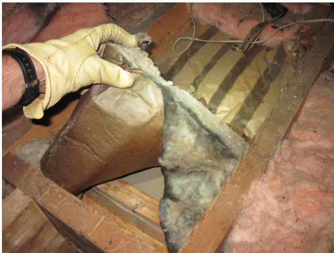
Figure 46- Vue de l'isolant à l'intérieur des combles
