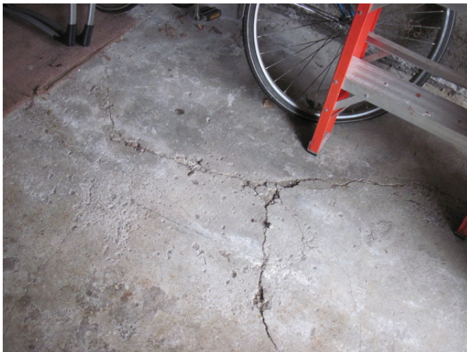
Figure 41- Fissures de la dalle de béton au garage
