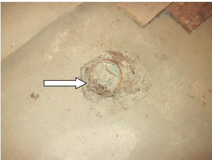
Figure 34- Regard de nettoyage de la conduite d'évacuation principale
