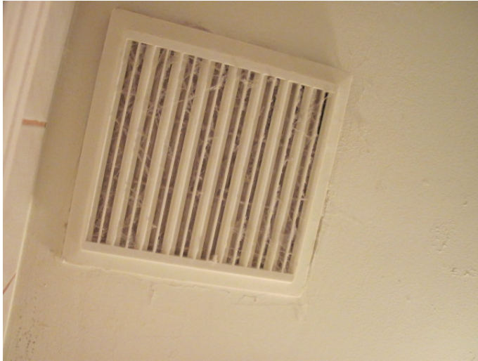
Figure 49- Grille de ventilateur d'extraction à la salle de bain
