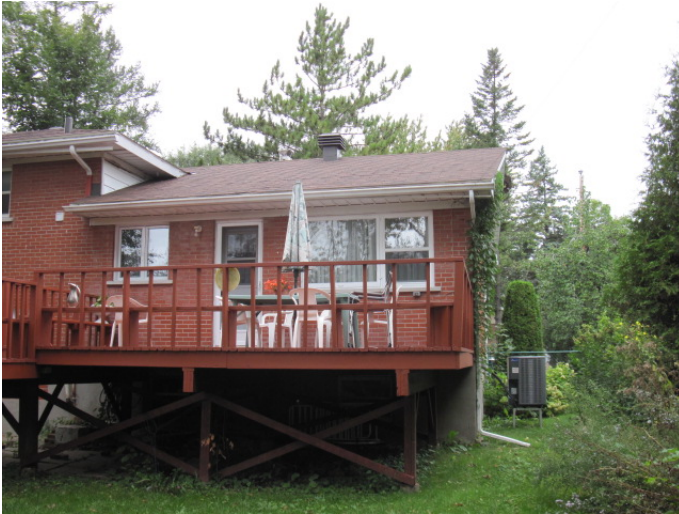
Figure 23 - Balustrade de terrasse non sécuritaire
