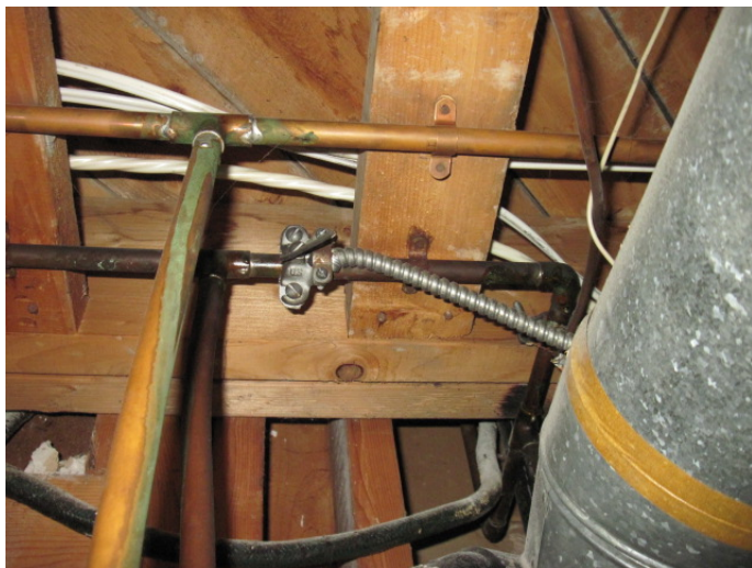
Figure 27- Connexion de la mise à la terre au sous-sol
