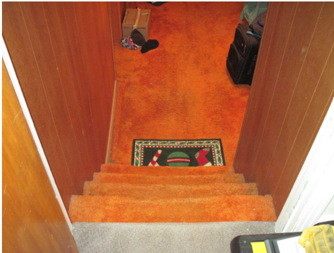
Figure 44- Absence de main courante dans la descente d'escalier
