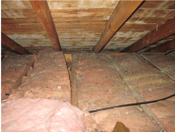
Figure 45- Vue de l'isolant à l'intérieur des combles
