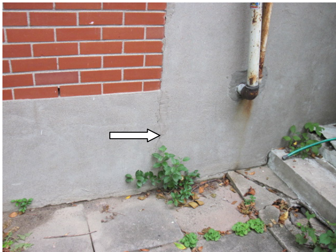
Figure 3- Fissure au mur arrière
